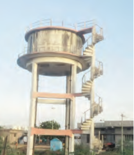
కాలనీ ఎక్స్‌నెట్ ఉన్న మిషన్ భగీరథ నీటి ట్యాంక్
